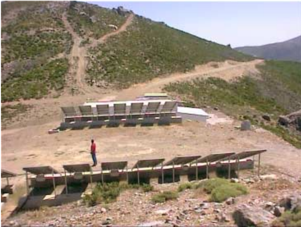
Bild 7: PV-Generator 1 und 3 vor Elektro-Haus
