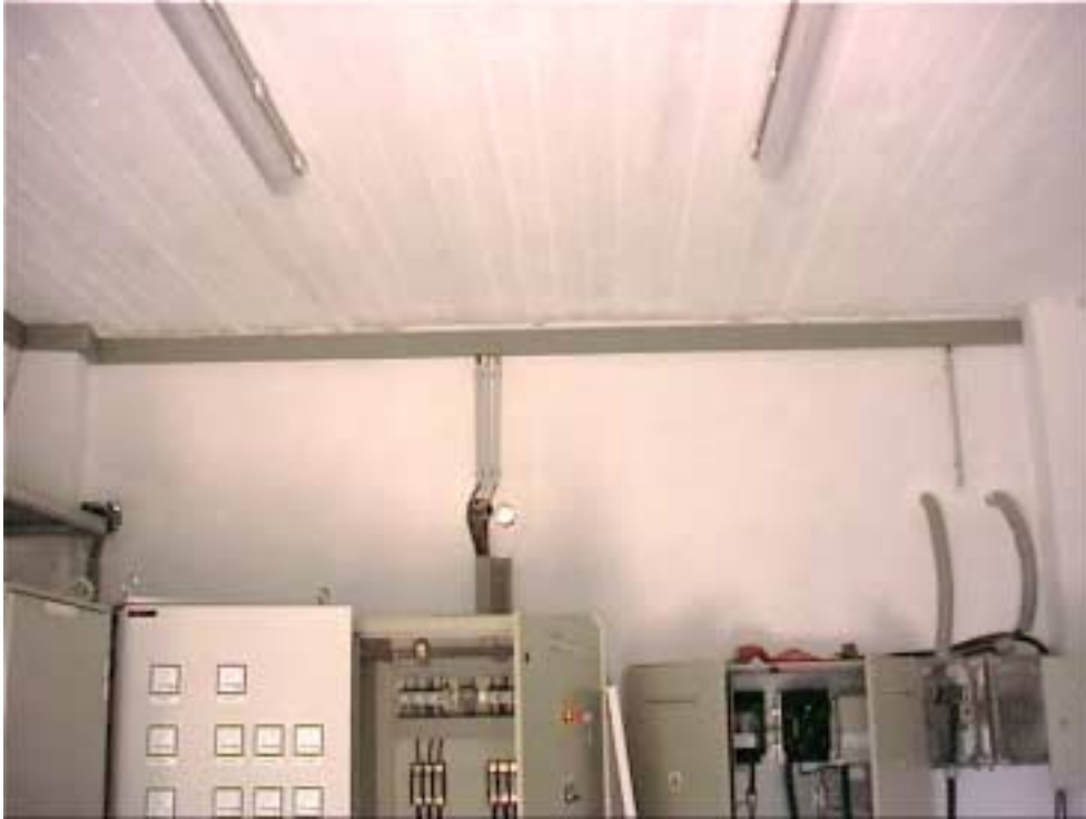
Bild 14: Kabeleintritte in Elektro-Raum (links: PV-Generatoren; Mitte: Appartement-Haus/Käserei; rechts: WEA und Biogas-Anlage)
