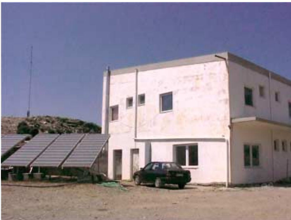
Bild 8: PV-Generator 2 mit Appartement-Haus
