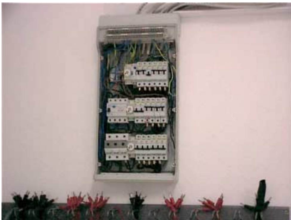
Bild 16: Verteilung im Elektro-Haus
