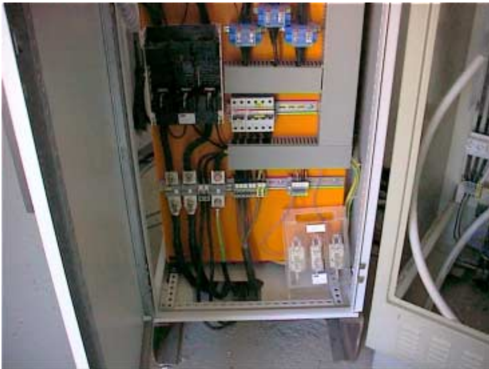
Bild 15: Kabeleintritt großer Wechselrichter (PV-Generator 1)
