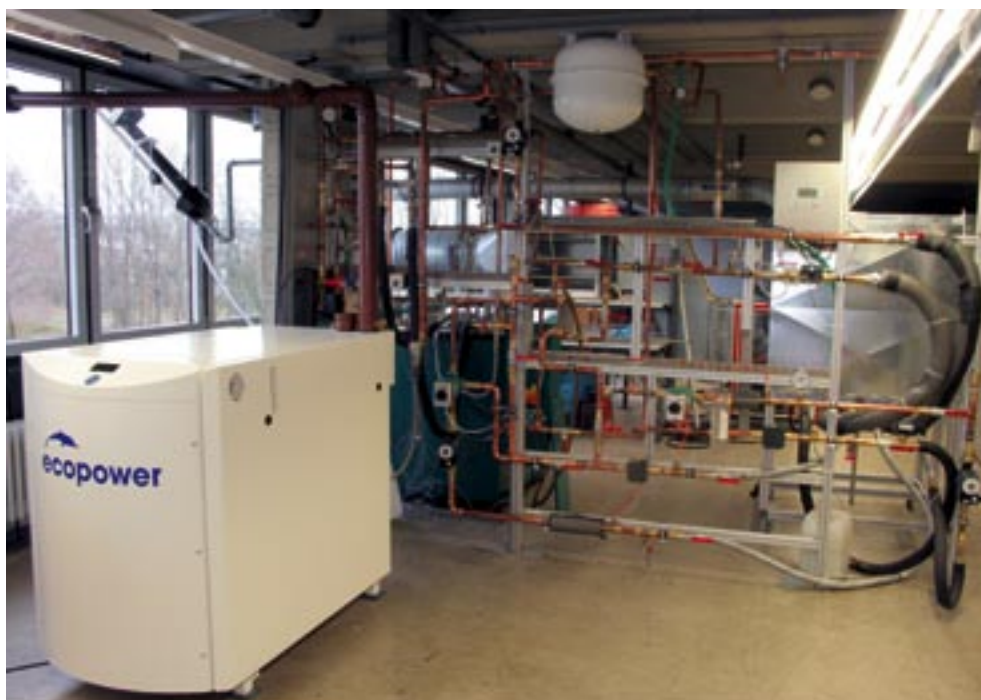
Abb.: KWKK Teststand mit 2 BHKWs und einer Kältemaschine
