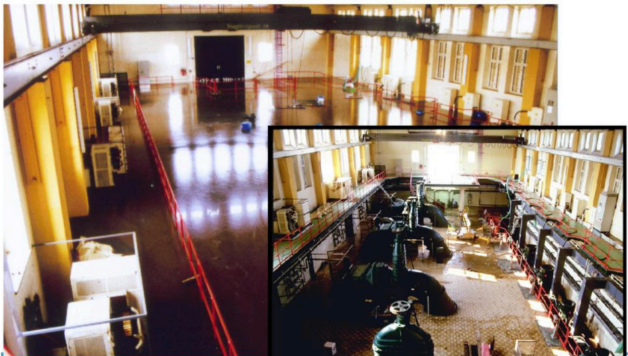
Bild 7: Überflutung Zulaufpumpwerk Dresden-Kaditz
