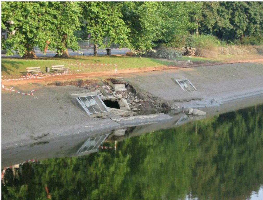
Bild 6: Zerstörter Hauptkanal am Zwingergraben
