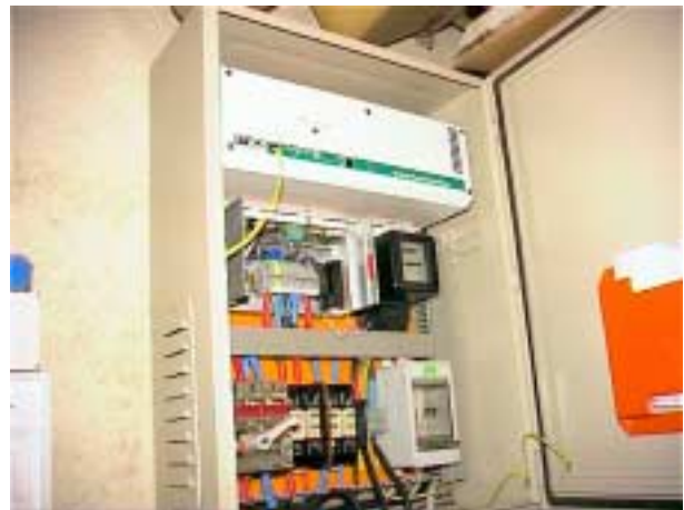
Bild 17: Schaltkasten mit Wechselrichter
