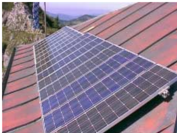
Bild 16: PV-Generator auf dem Dach
