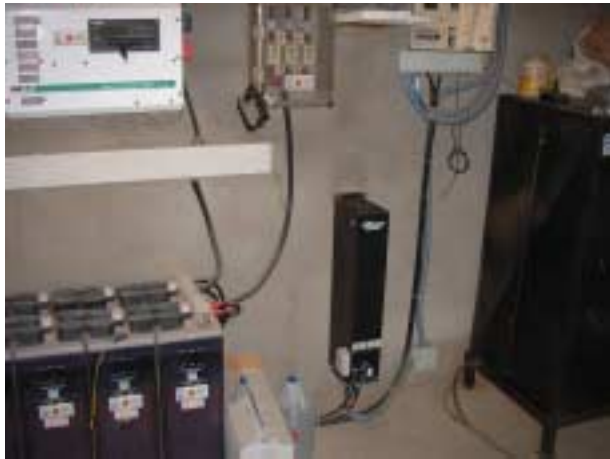
Bild 3: Gleichrichter, Laderegler, Batterien und Wechselrichter im Elektrohaus
