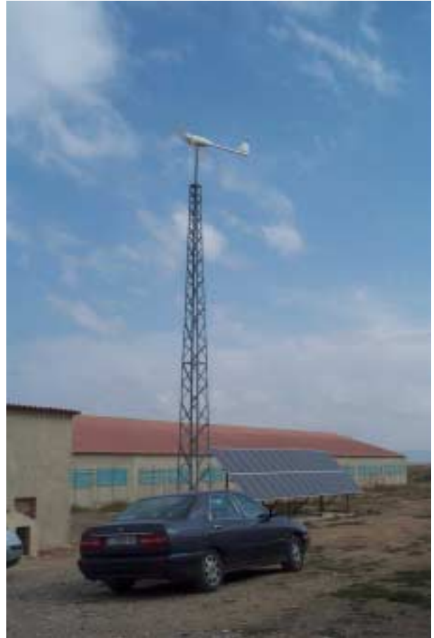
Bild 2: Windkraft- und Photovoltaik-Generator
