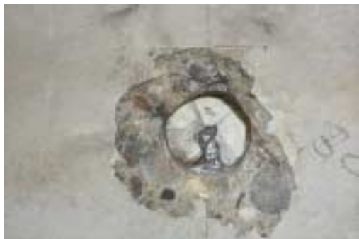
Bild 10: Anschlussvariante „I“: Zerstörter Prüfling I.5.
