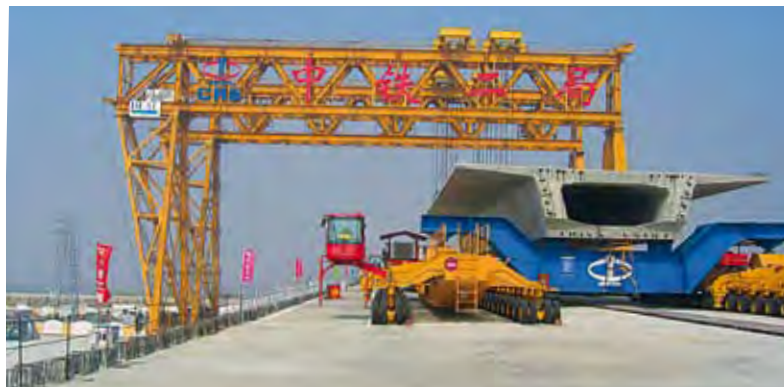
Riesige Betonbauteile werden in vier Jahren Arbeit zur längsten Brücke der Welt zusammengesetzt
